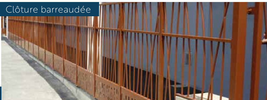
Garde-corps et portillon
